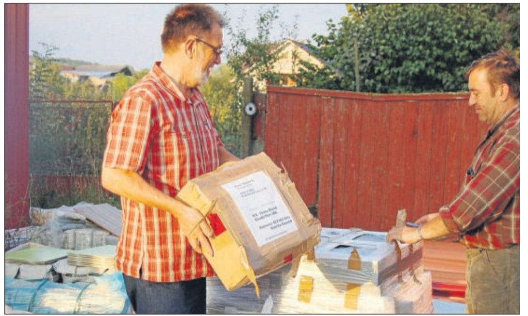
Bei Bauarbeiten: Am Kinderheim in Ilisua waren dringende Instandsetzungsarbeiten nötig. Heinz Thiel konnte mit seinem Verein helfen. Foto: privat
